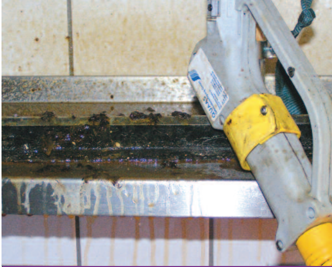
Der Dampf hat den Film aus Fett, Öl und Staub aus der Abluftanlage gelöst
