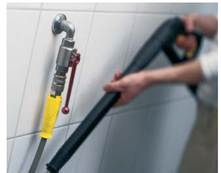
Fest installierte Hochdruck-Entnahmestelle
